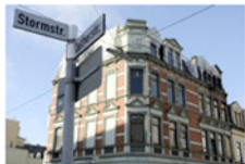
Das Haus Sturmstraße 44 bereitet der Stadt Kopfzerbrechen. Nach einem Brand ist der Wert gegen Null gesunken. Es ist nur eines von rund 50 Gebäuden in Lehe, hinter deren Gründerzeitfassaden sich Leerstand und Verfall ausbreiten, weil die Eigentümer nicht mehr investieren. Foto: IS
